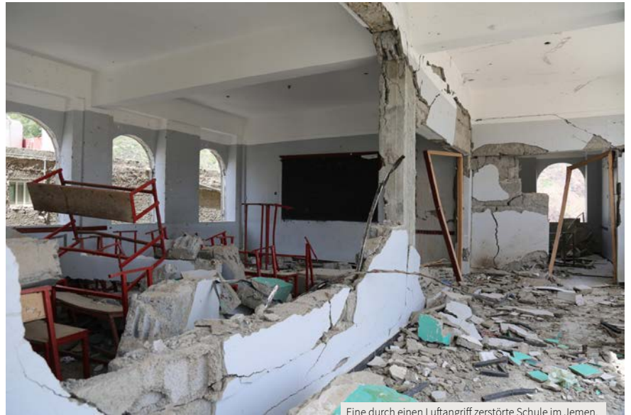
Eine durch einen Luftangriff zerstörte Schule im Jemen. Foto: Mwatana für Human Rights Watch
